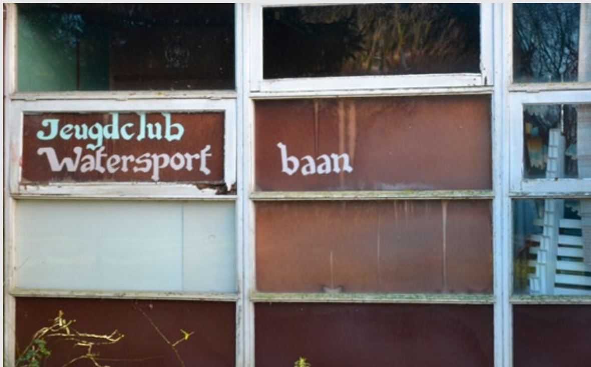
Fig. 8: Het vervallen gebouwtje in het centrum van de wijk (aan de Kring), is een basisschool en daarna een jeugdclub geweest. Momenteel zijn er geen overdekte buitenruimtes voor kinderen en tieners uit de wijk
